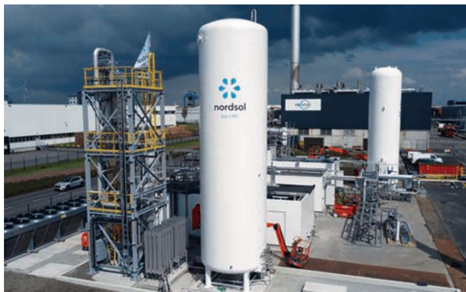
Nordsol bioLNG tank
