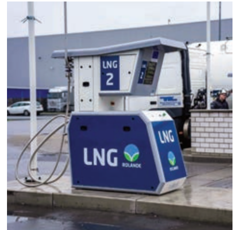
LNG station in Duisburg, Germany
