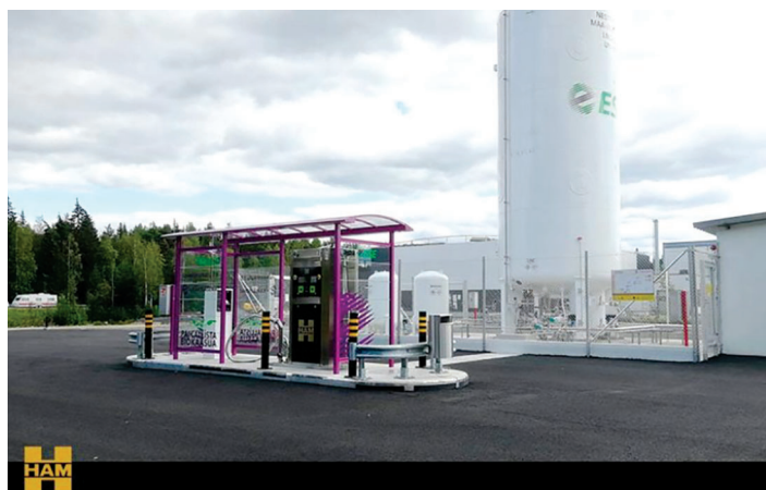
HAM LNG station Finland
