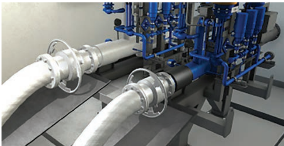
LNG fuel supply system
