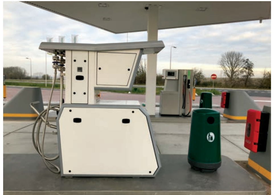
Cryostar LNG dispenser
