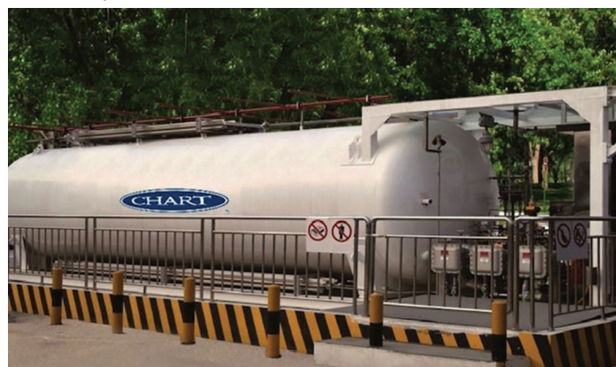
Chart Ferroxx LNG Bunker station
