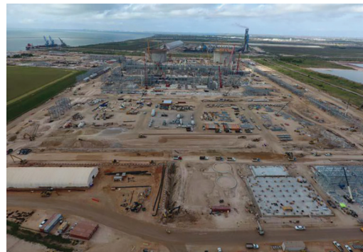
Cheniere's Corpus Christi LNG site
