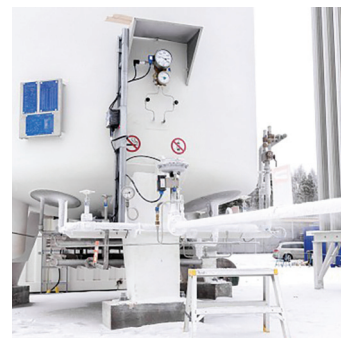
LNG tank-photo Stormossen
