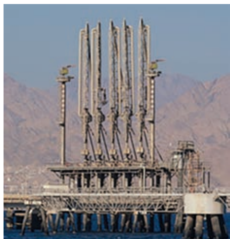
Fig. 5: Marine Loading Arms at LNG Jetty (photo courtesy from Oman LNG)
