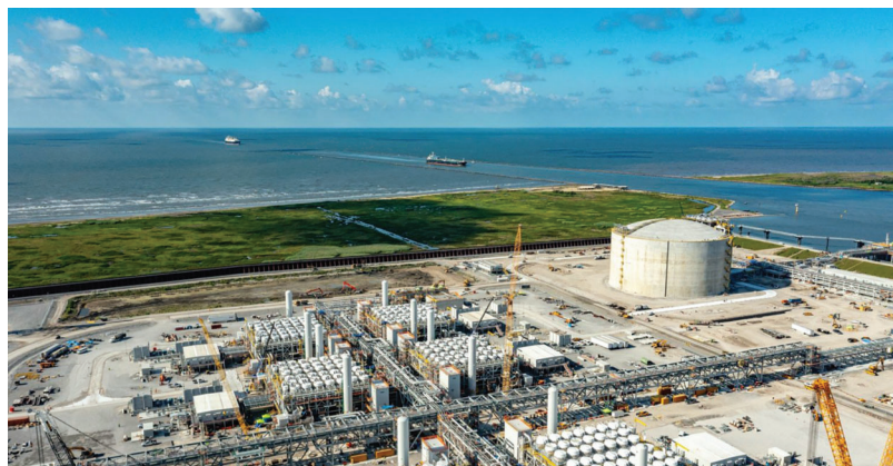
Calcasieu Pass LNG terminal
