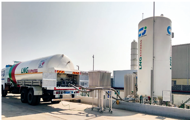
LNG fuelling station
