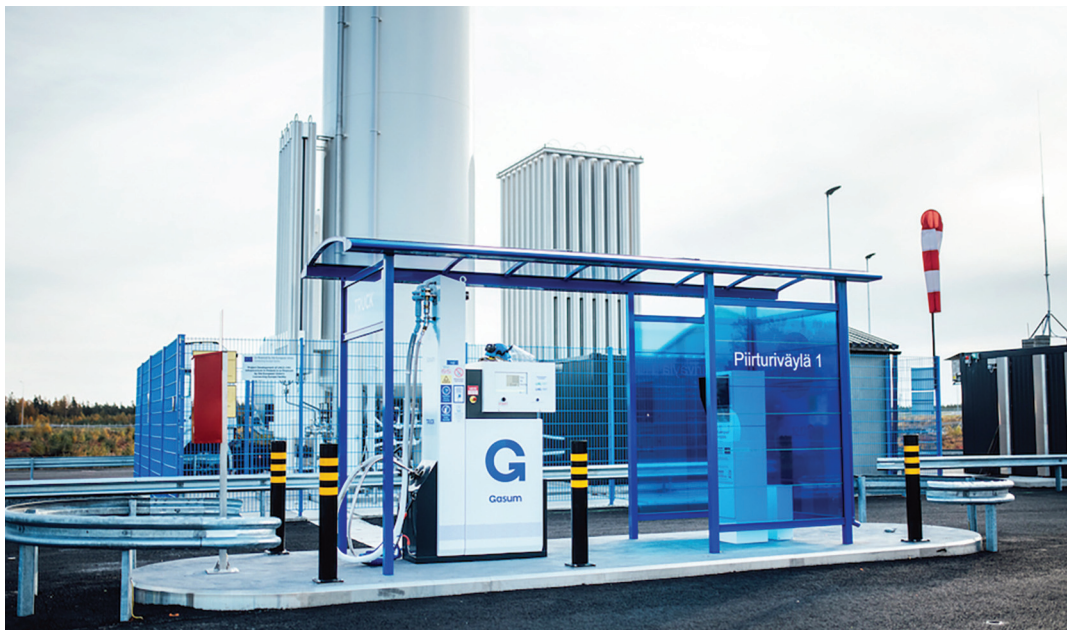
Gasum LNG fuelling station
