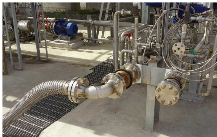
KLAU LNG system
