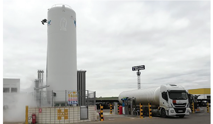
HAM LNG station in Spain
