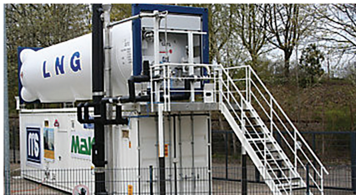
The LNG test bed in Kiel, Germany
