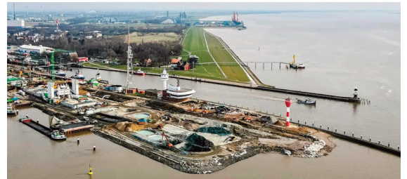
Brunsbüttel LNG import terminal
