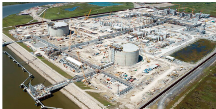
Render of Commonwealth LNG project
