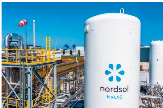
Nordsol bioLNG tank
