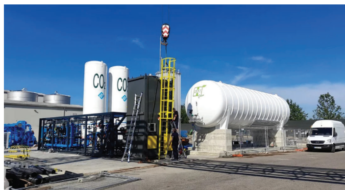
Lipigas LNG facility
